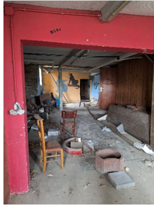
Annexe 3c : Dégâts
